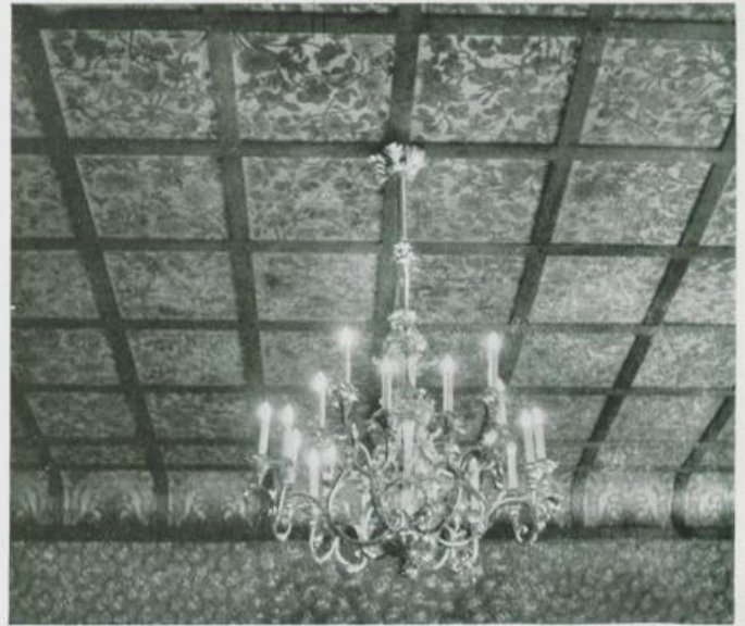
Decke des Speisesaales
